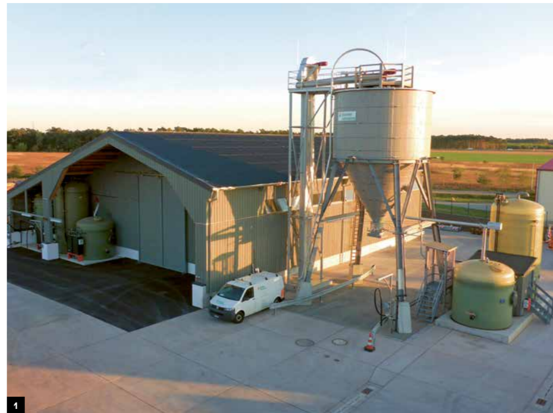
1 Fahrbinde (DE), komplexné zariadenie so skladovacou halou soli, 1 x 100 m 3 valcové silo, soľanková technika a dopravná technika
