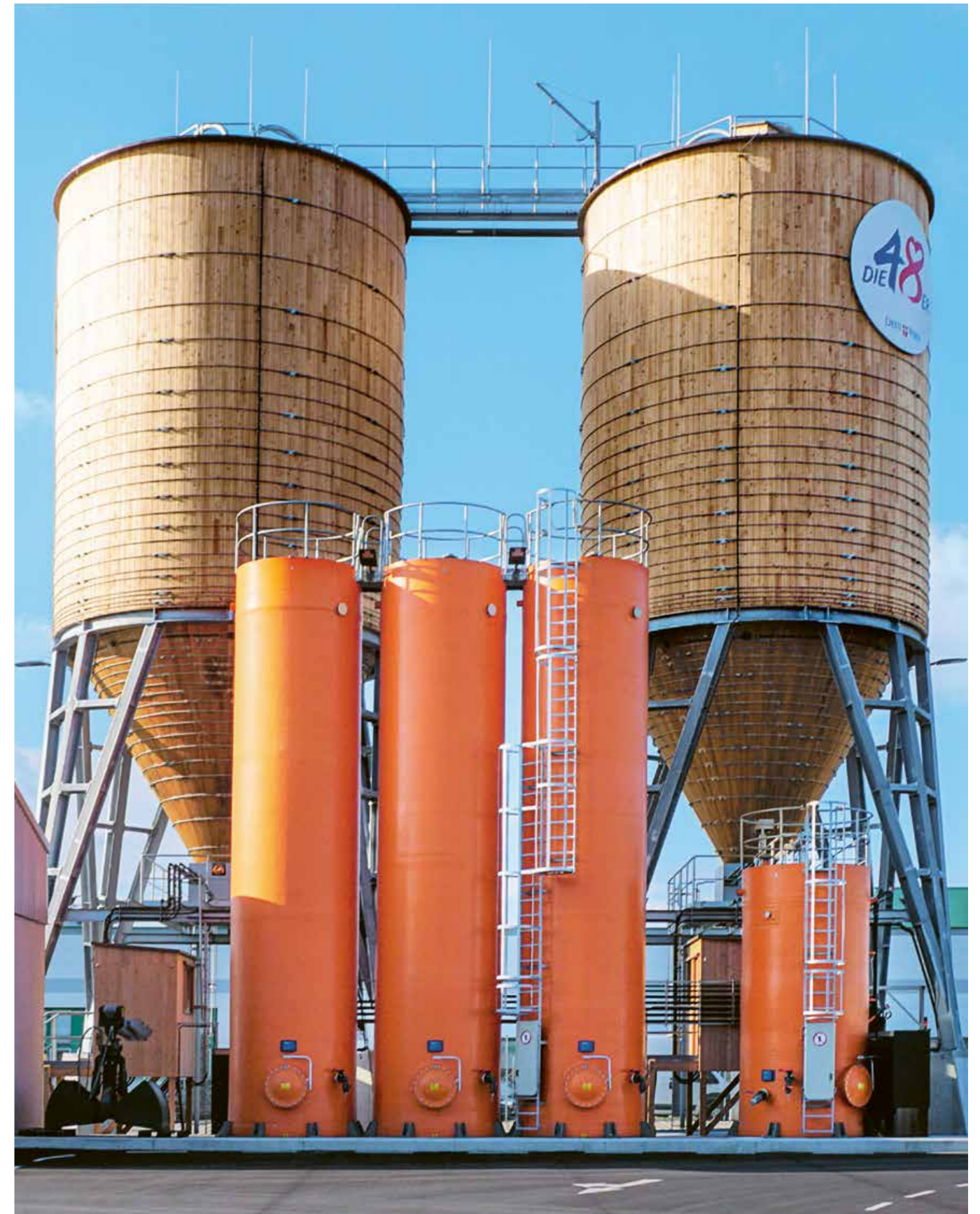
Viedeň (AT), 2 × 500 m 3 valcové silá a 3 × 45 m 3 nádrže na soľanku so zariadením na výrobu soľanky.
